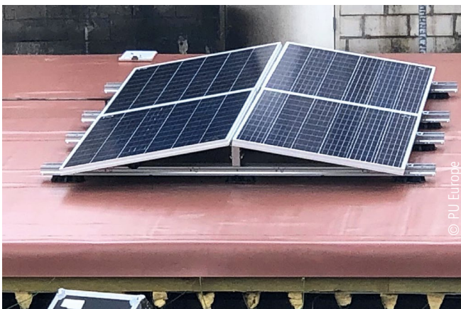
Abb. 4 Versuchsaufbau mit PV-Modulen
